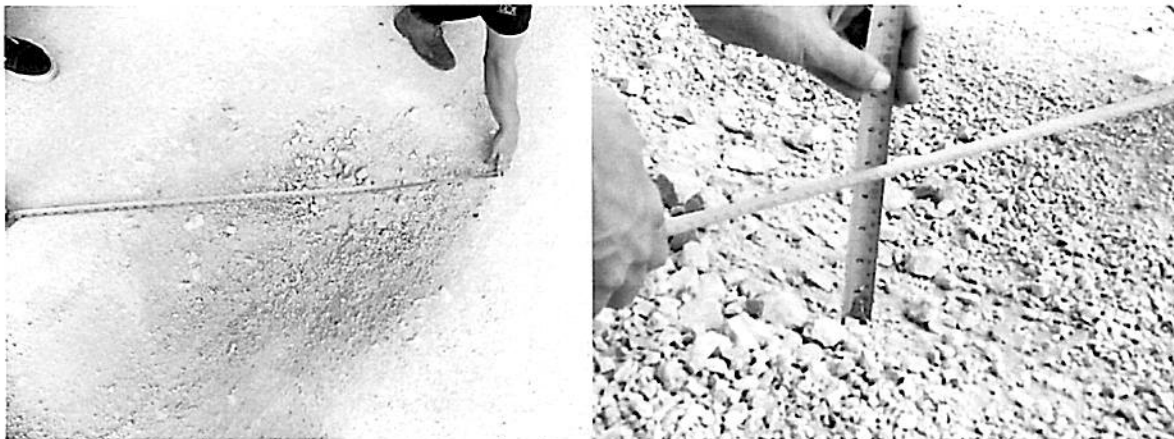
Figura 6. Huecos de hasta 120cm de diámetro y 5cm de profundidad. Estación 1+360. Fecha: 30/05/2018. Fuente: LanammeUCR
