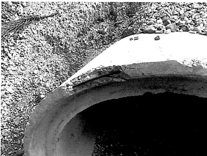
Figura 4. Acero de refuerzo expuesto en la alcantarilla ubicada en la estación 3+795. Fecha: 30/05/2018. Fuente: LanammeUCR
