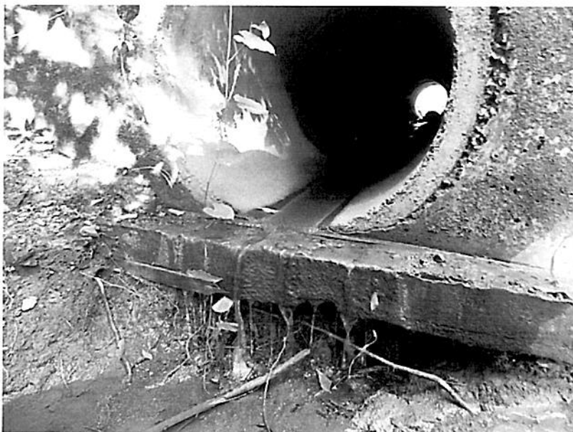
Figura 4. Socavación de la alcantarilla ubicada en la estación 6+950. Fecha: 30/05/2018. Fuente: LanammeUCR
