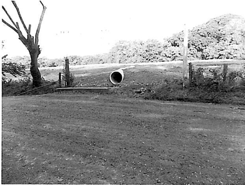
Figura 2. Alcantarilla sin cabezales ubicada en la estación 6+450. Fecha: 30/05/2018. Fuente: LanammeUCR
