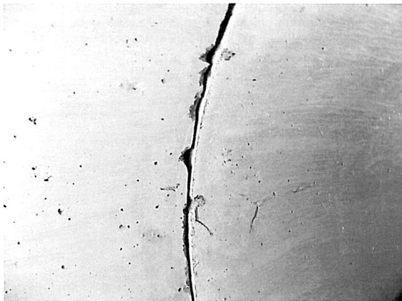
Figura 1. Uniones entre tubos de alcantarilla sin relleno de mortero. Estación 3+795. Fecha: 30/05/2018. Fuente: LanammeUCR
