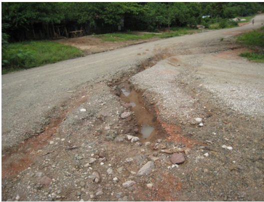
Imagen calle al Norte de Barrio Negro y las consecuencias de la carencia de sistema de aguas pluviales.
