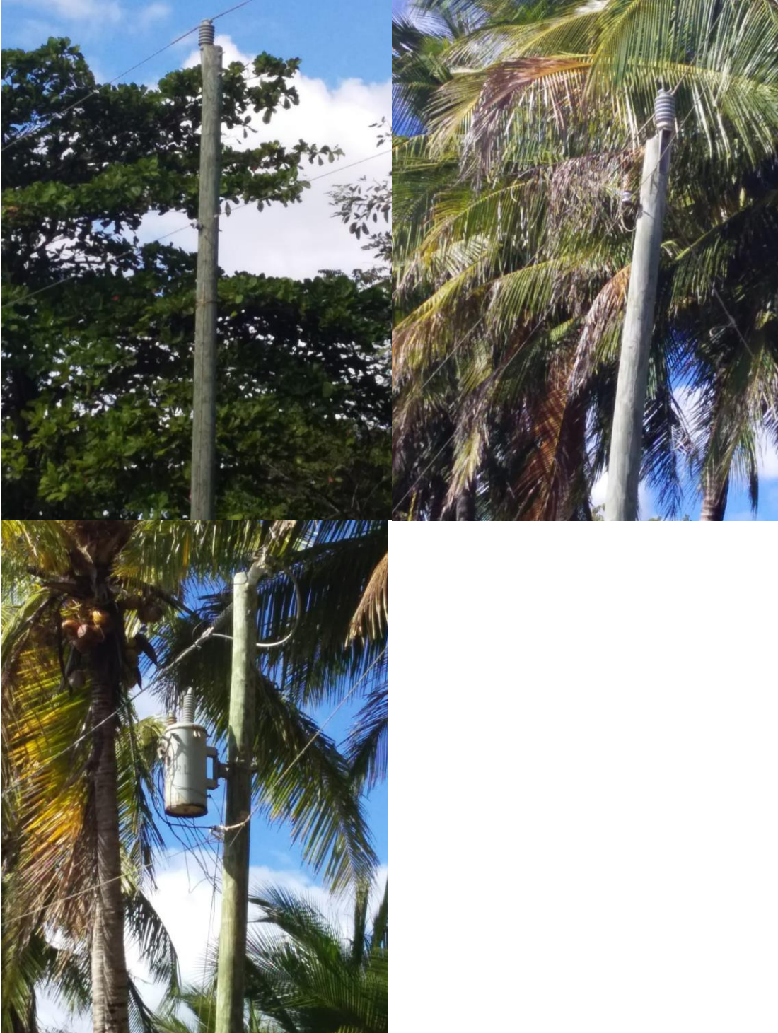
Postes del tendido eléctrico en Playa Coco, Marbella.
