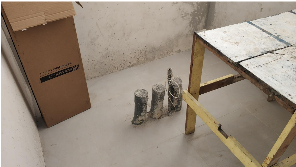
Figura 12. Tuberías para fibra óptica y telefonía convencional. Ubicación del gabinete de comunicaciones
