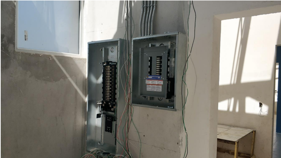
Figura 9. Únicos 2 tableros eléctricos instalados de los 5 del proyecto
